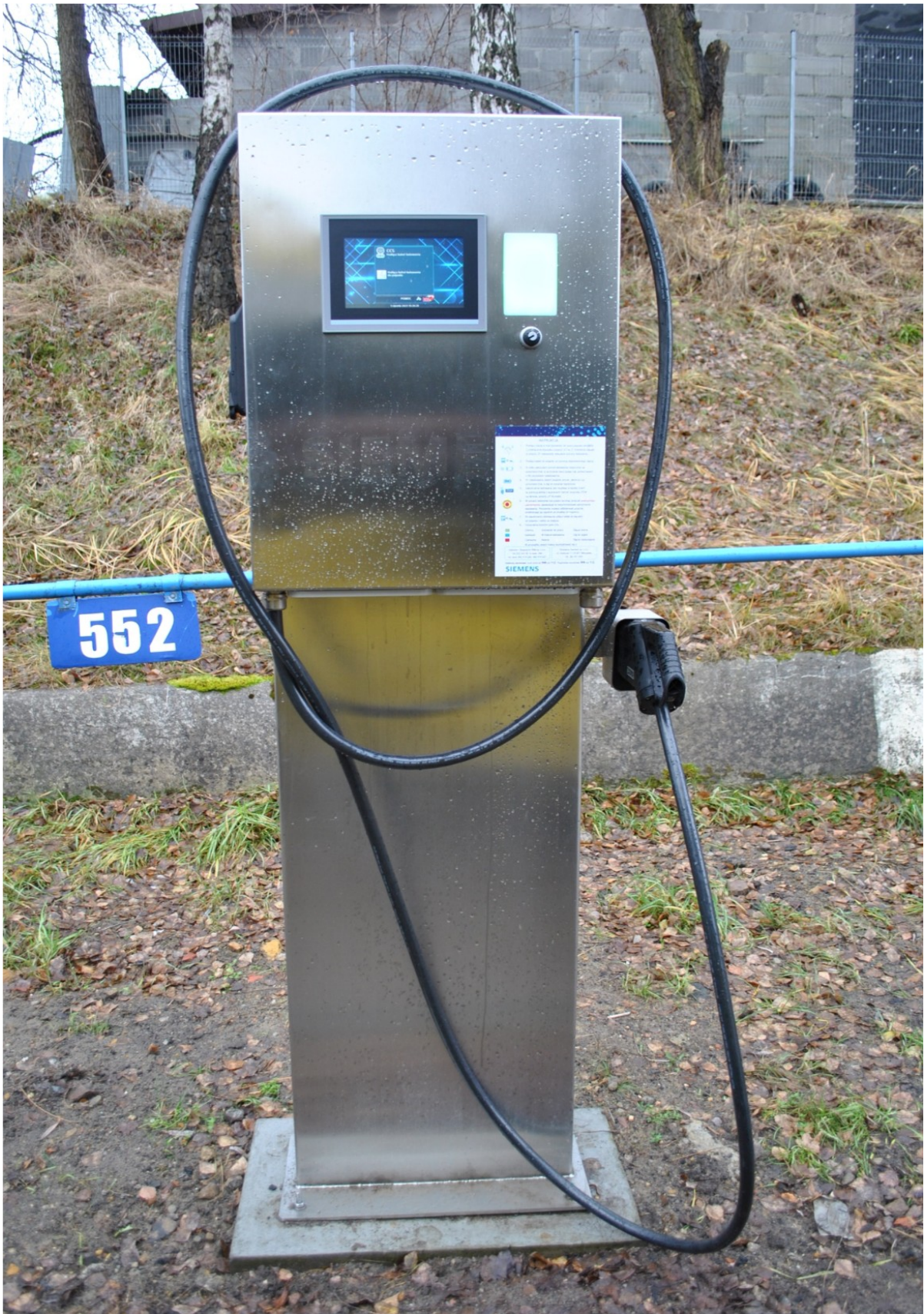
Ładowarka do autobusów Solaris Urbino nH12 i Solaris Urbino nH18 (Czyste niebo nad
