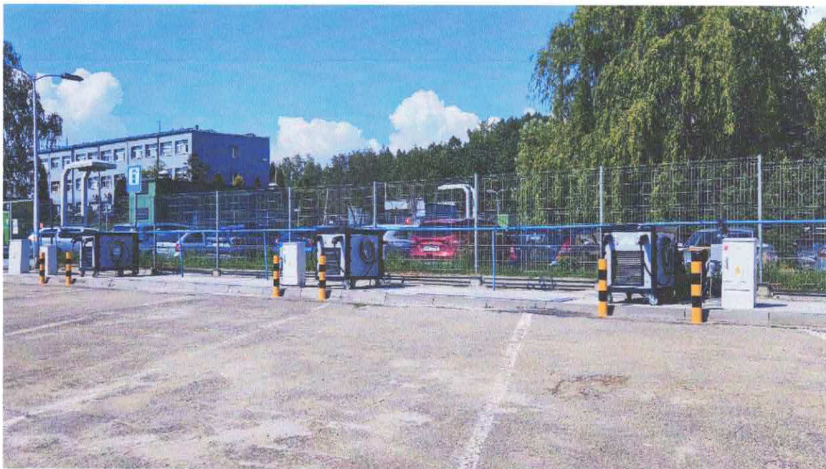
Ładowarki o mocy 80 kW zlokalizowane na zajezdni przy ul. Lenartowicza 73 w Sosnowcu
