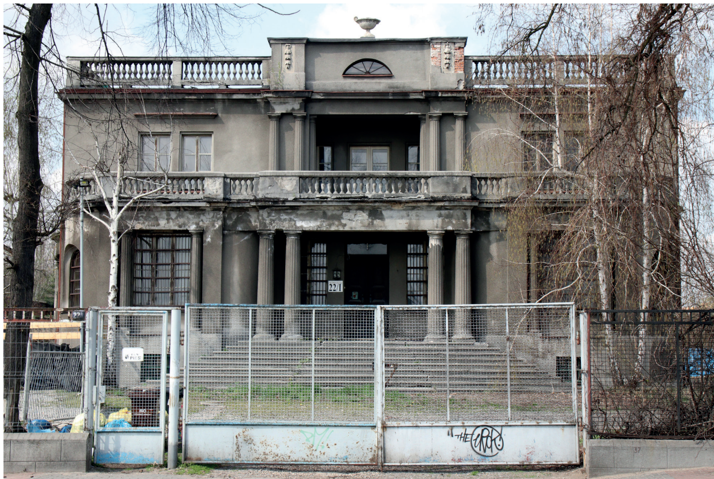
Willa Piątkowskiego, al. Mireckiego 27. Bydynek powstał na pocz. XX w. W 1920 r. rozbudowany przez właściciela. Stan zabytku dostateczny.
